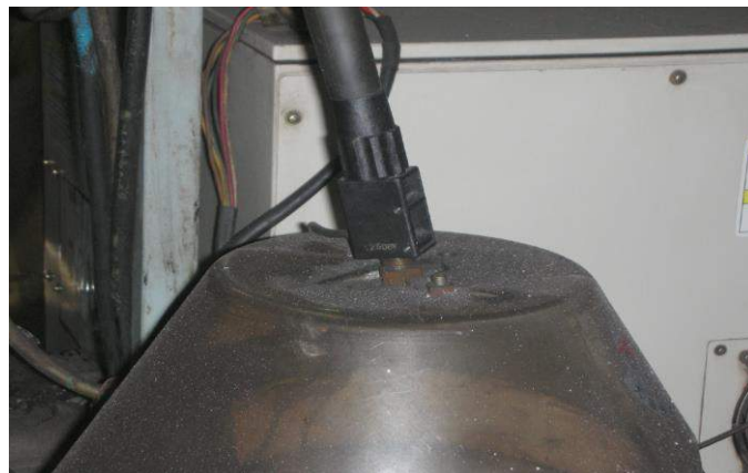
▲ 図 027-01 透明傘破損による 1 次側コンジットの倒れ（透明傘破損、引き出し金具締め付け不良などによるコンジット倒れはワイヤキズ、ワイヤ曲りに直結）
